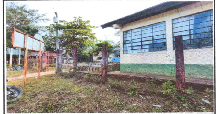
Foto 4: Se observa la continuación de la circulación del predio deteriorado
