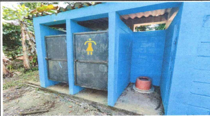
Foto 3: Se observa que hace falta una puerta metálica en el baño de pozo ciego
