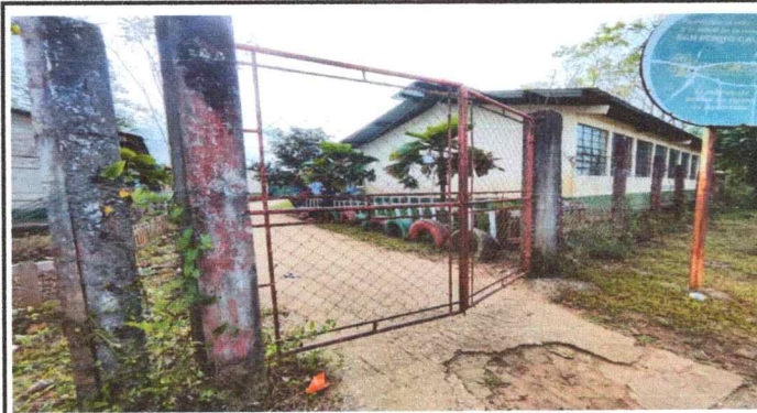
Foto 3: Se observa el inicio de la circulación del predio de la escuela en estado deteriorado
