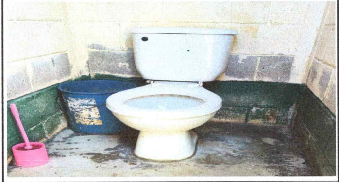
Foto 2: Se observa el deterioro del tanque de agua de los inodoros
