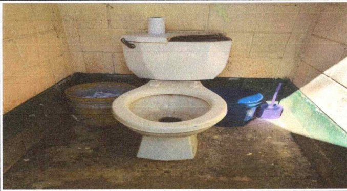
Foto 1: Se observa los inodoros quebrados y en mal estado
