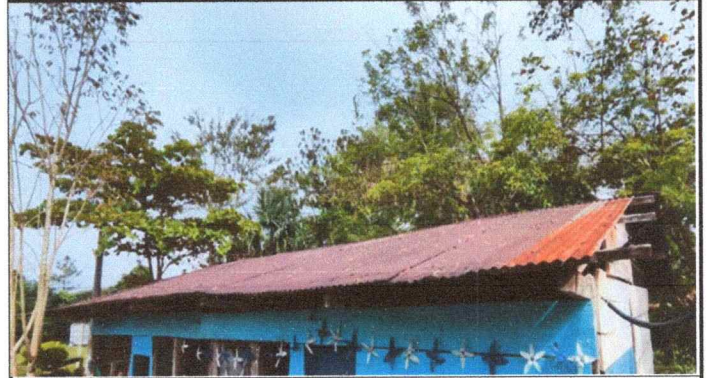
Foto 2: Se observa el deterioro de la lamina del aula de tercero y cuarto primaria
